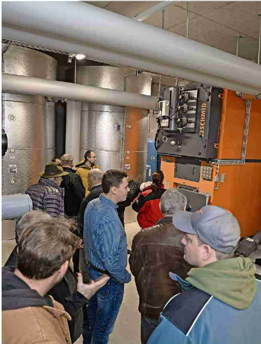
Der 550-Kilowatt-Heizkessel stand am Tag der offenen Tür im Mittelpunkt des Interesses.
