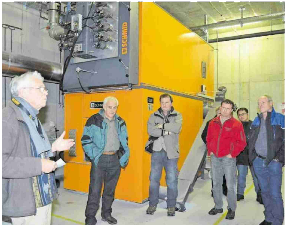
Klaus Forster (links) erläutert vor dem Holzschnitzelkessel die Funktion des Wildhauser Wärmeverbunds.
