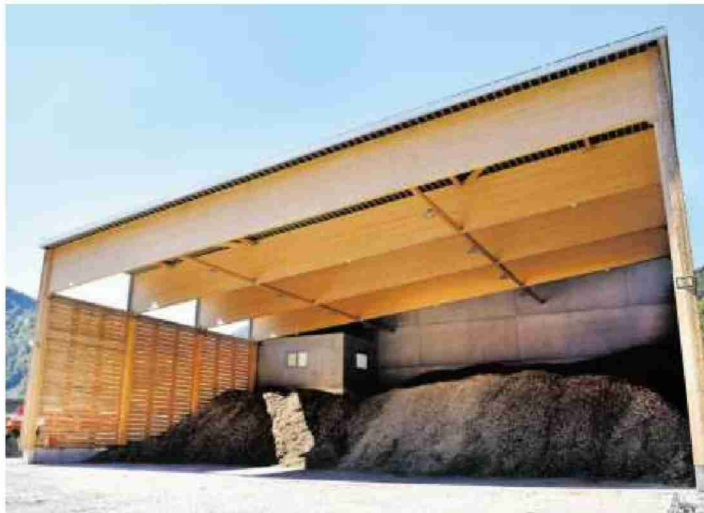
In der Heizzentrale ist auch das Holzschnitzeldepot untergebracht.
