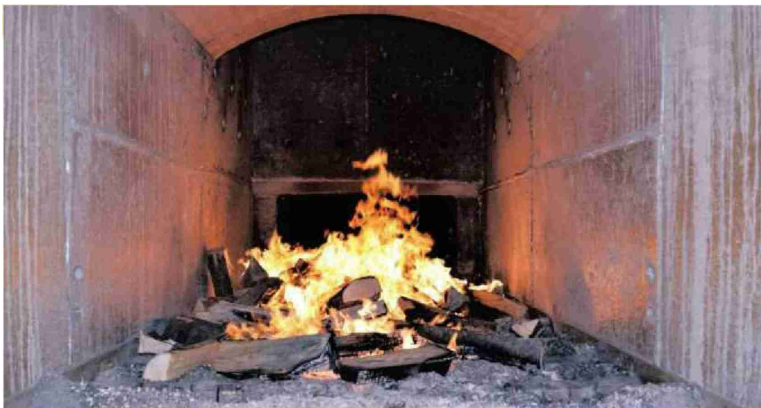
Der Feuerraum beim ersten Anfeuern der Holzschnittelheizung in der Heizzentrale im Flooz.
