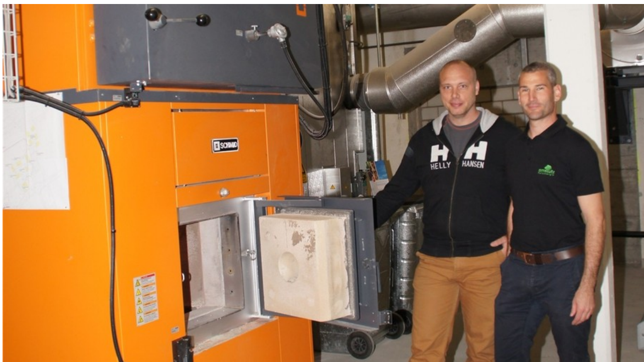
Holzschnitzel-Heizungsanlage im Schulhaus mit Anlagewart Samuel Buess (l.) und Projektleiter Tobias Schneebeli von der Firma Amstutz Holzenergie AG aus Emmen.
