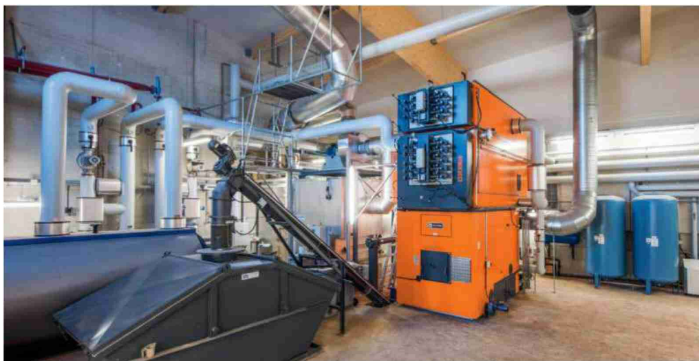
Vue de l'intérieur de la chaufferie. Photo: Eveline Perroud pour le bureau d'architecte Philippe Langel SA
