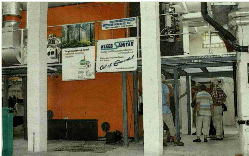
Das Herzstück des Wärmeverbunds Huttwil, der grosse Heizkessel.
