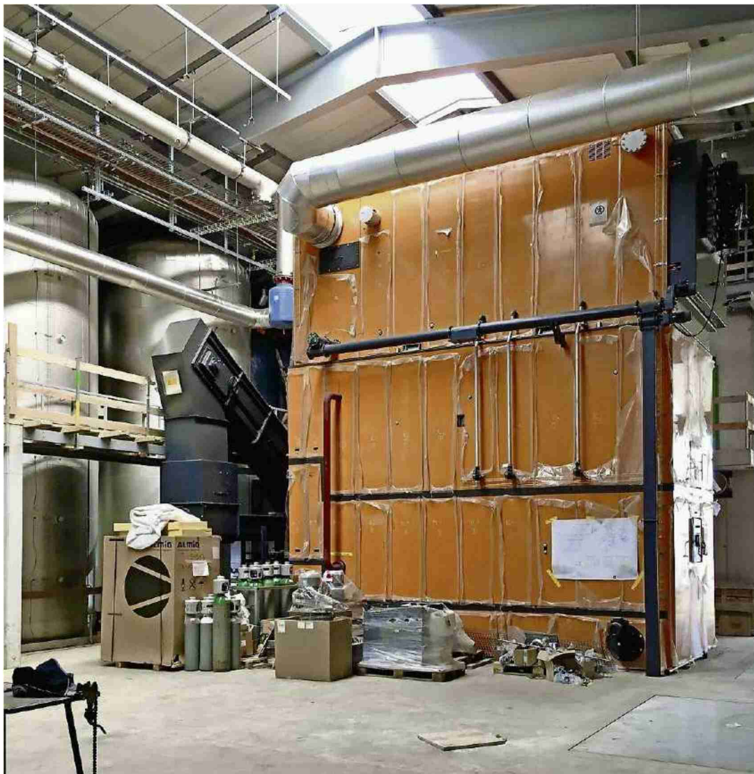
Holzsplit-Heizkessel und Heisswasserspeicher (links) in der Bremgarther Heizzentrale.
