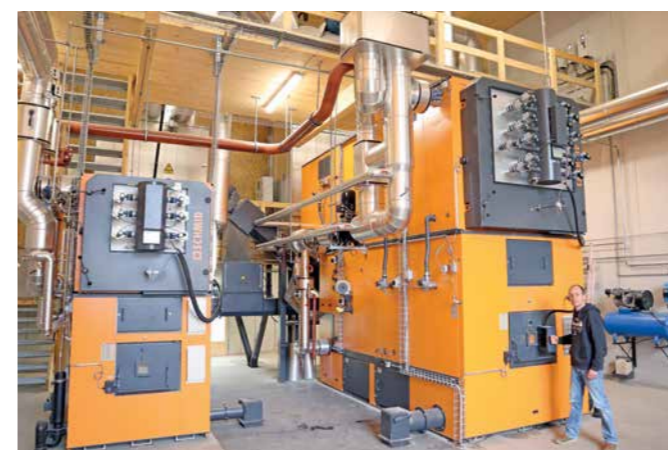
Lukas Frei ispeziona l'impianto: è membro del consiglio direttivo della cooperativa di riscaldamento Knonau.
