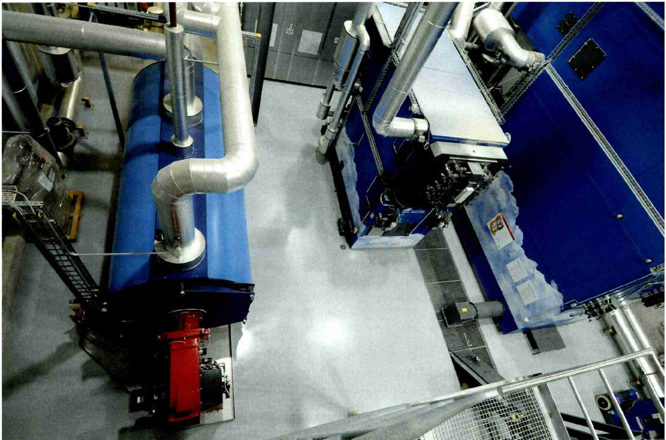
Blick in die Heizzentrale: Rechts die beiden Holzschnitzelöfen, wobei der acht Meter hohe Winterofen den Sommerofen überragt. Links der Ölbrenner, der zum Abfedern von Spitzenlasten und als Rückversicherung dient.
